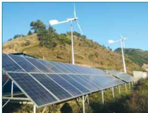
Figure 17: Mityal, Palpa Solar Wind Mini Grid
