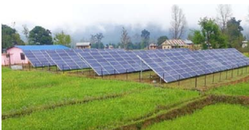
Figure 12: 100 kWp Gutu Solar Mini Grid, Surkhet
