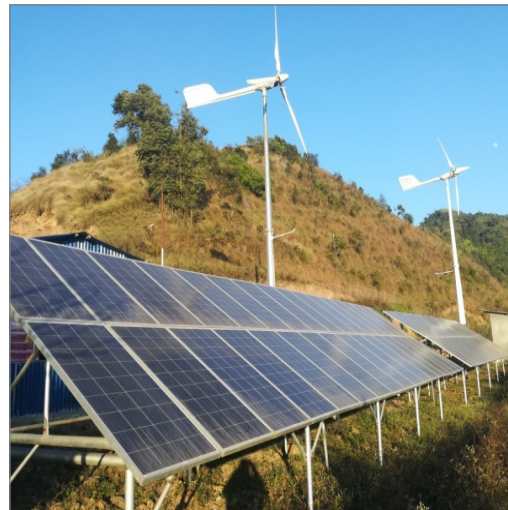
Figure 17: Mityal, Palpa Solar Wind Mini Grid
