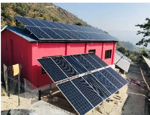
Figure 10: Hilepani Solar Mini Grid Project
