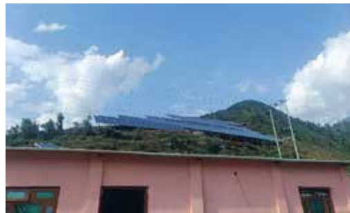
Figure 10: Barekot Solar Mini Grid Project (170 kWp)
